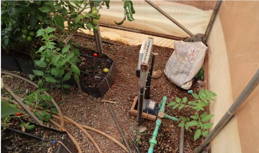
Abbildung 79: Pumpe für die Bewässerung (EIGENE AUFNAHME 2021)
